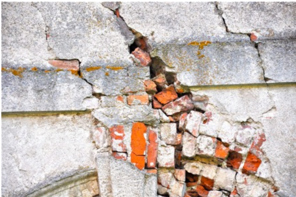
Powyżej uszkodzenie nadproża w zbliżeniu
